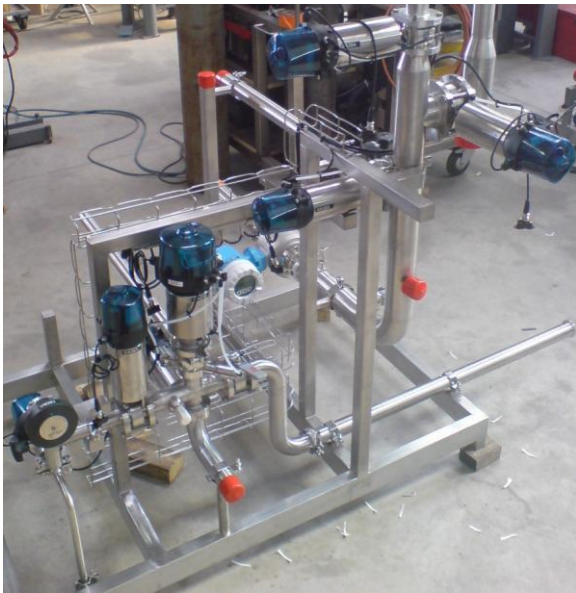
Le manifold CIP avec ses vannes et son débitmètre
