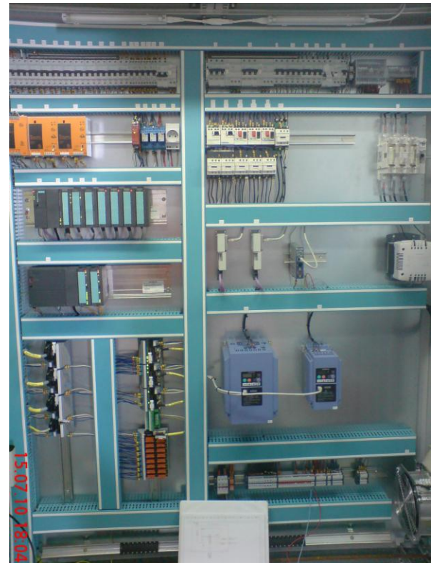
L'intérieur de l'armoire d'automatisme
